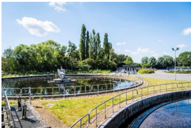
Het afvalwater wordt gezuiverd
