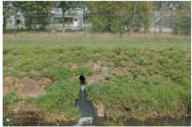
Het gezuiverde afvalwater wordt nog geloosd in de beek
